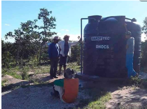
◀ Comunidade rural Pé do Morro recebeu a instalação de um poço artesiano em janeiro de 2022
